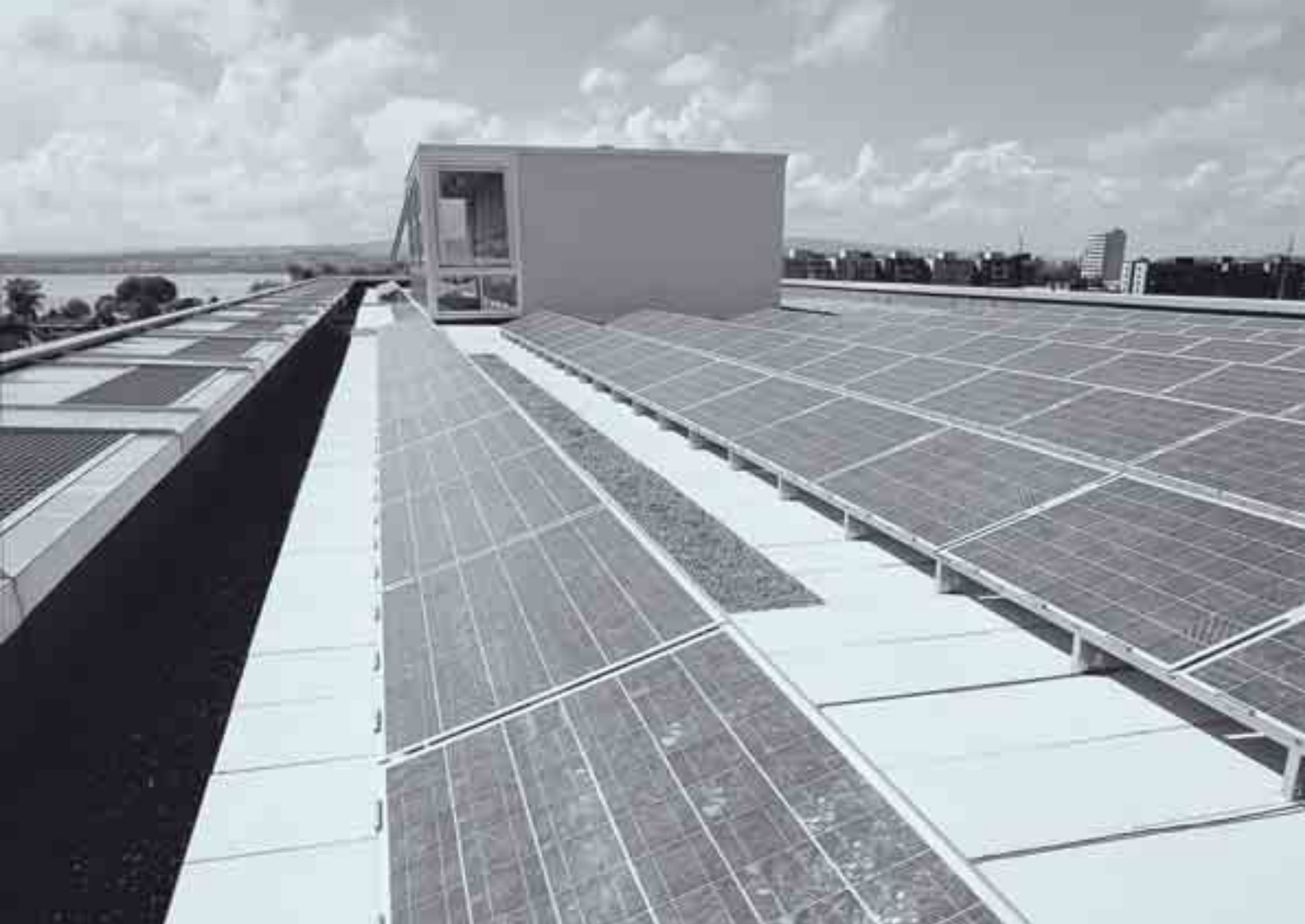
Die Fotovoltaikanlage auf dem Dach des Kaufmännischen Bildungszentrums Zug (KBZ) ist ein wirksamer Beitrag für die gute Zuger Luft.
